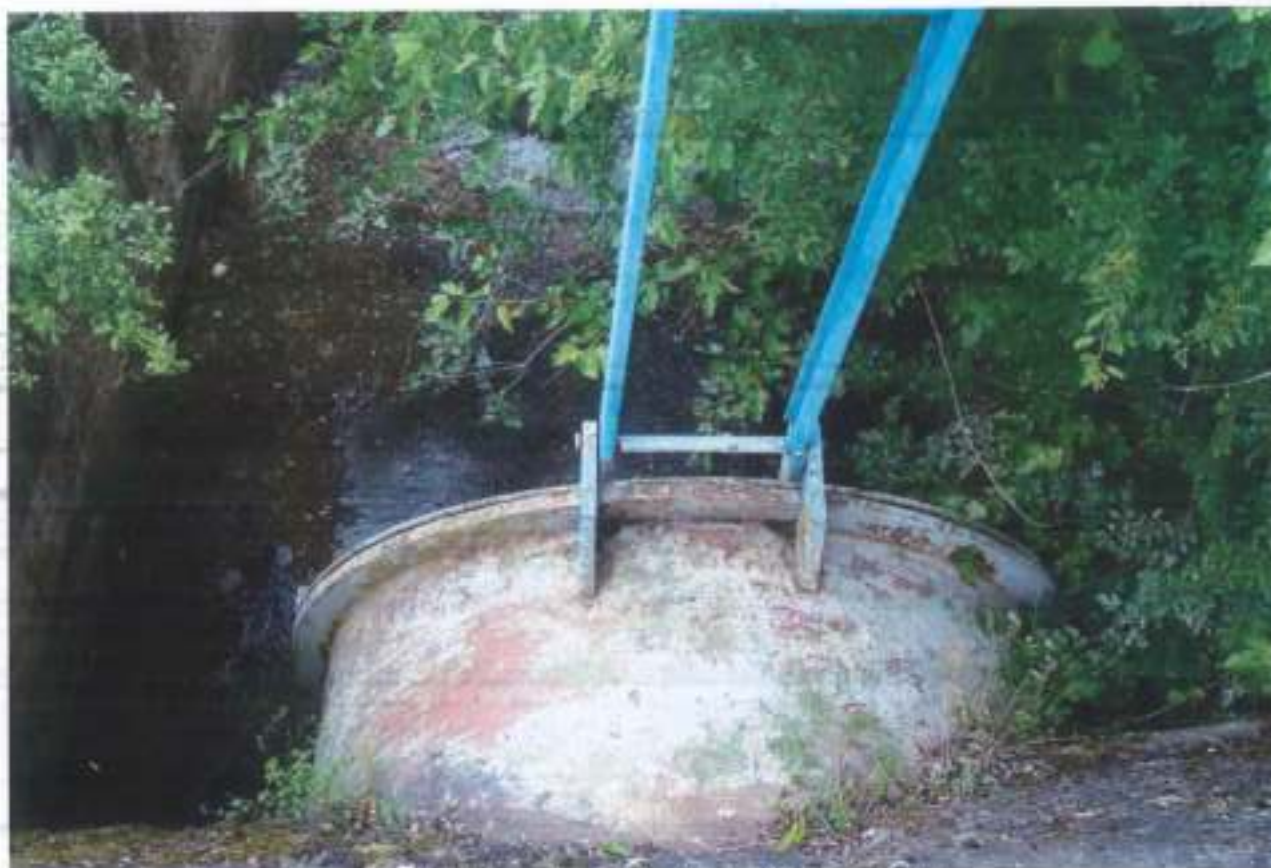
Figura 12 – Degradarea radierului și expunerea armăturii
