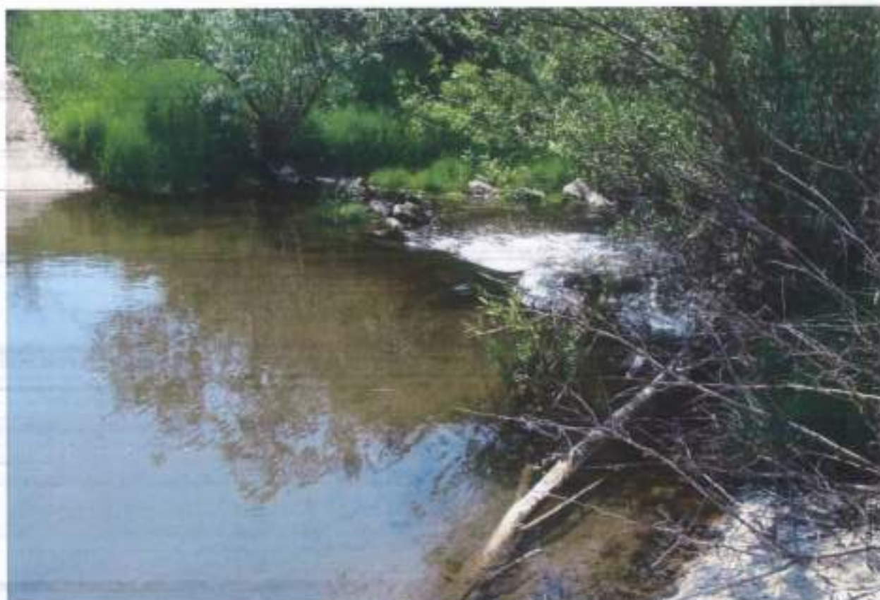
Figura 8 – Lipsa rizbermei mobile în capătul aval al disipatorului de energie.
