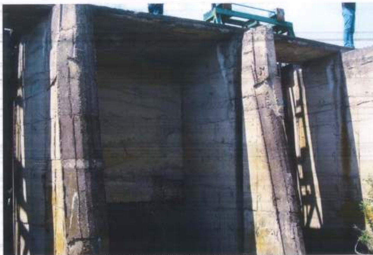
Figura 6 - Expunerea armăturii de rezistență la partea inferioară a platformei
