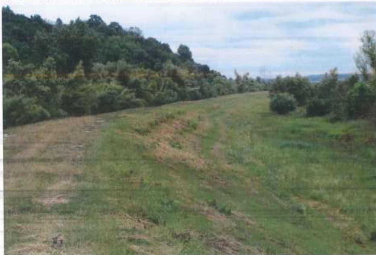
Figura 19 -Dig de contur care prezintă tasări la nivelul coronamentului
