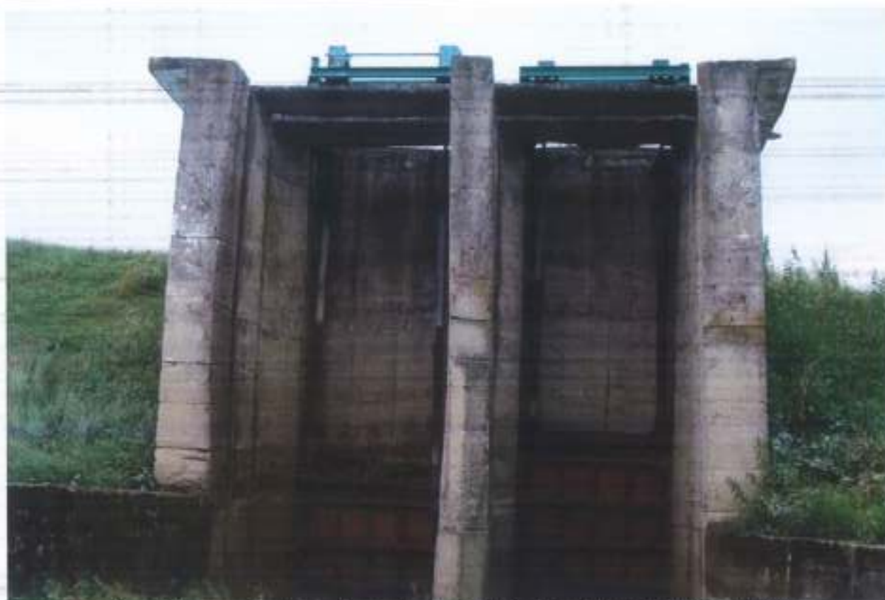
Figura 14 – Degradarea betoanelor structurale ale platformei care asigură sistemul de acționare
