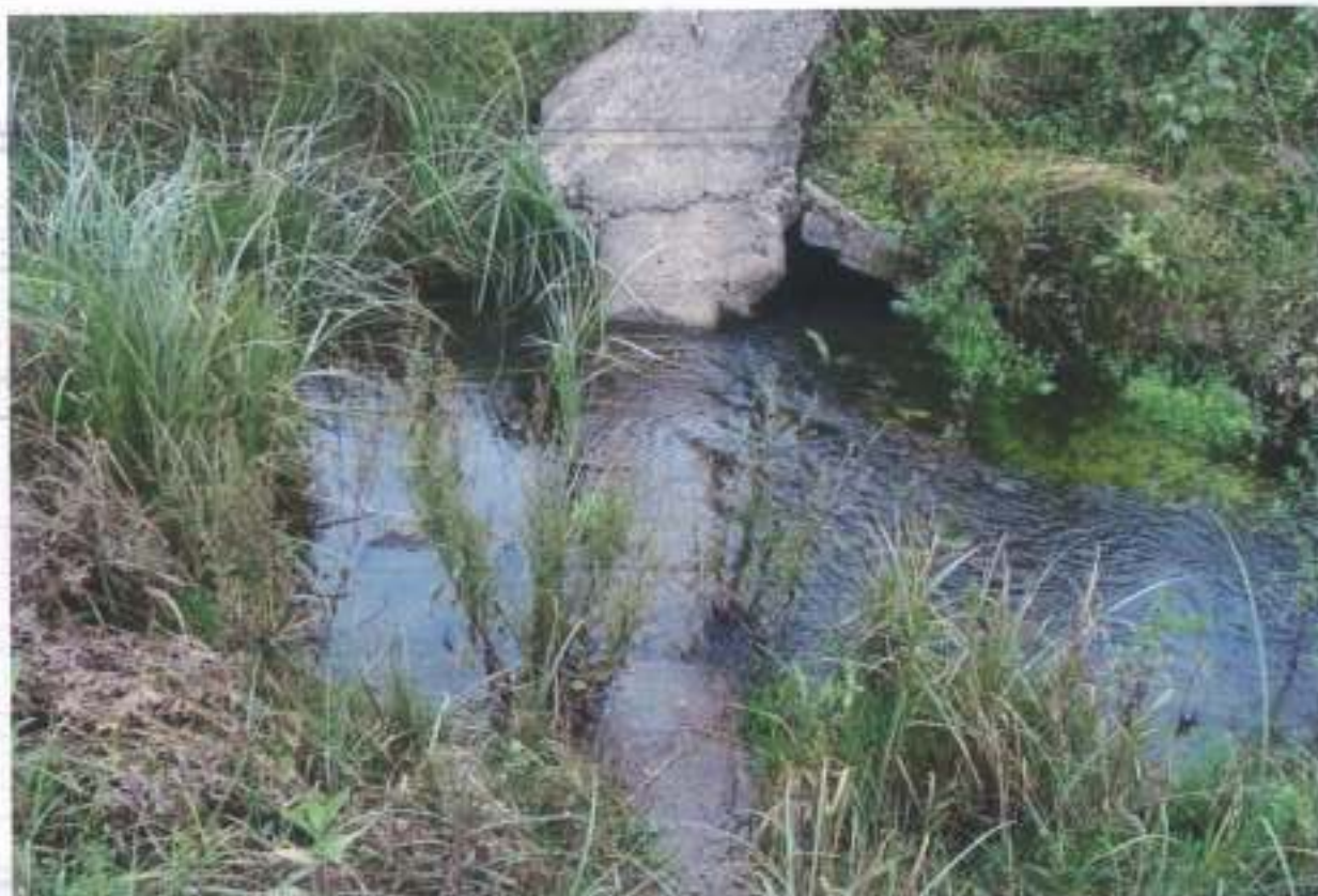
Figura 16 – Degradare pragului de fund în incinta polderului
