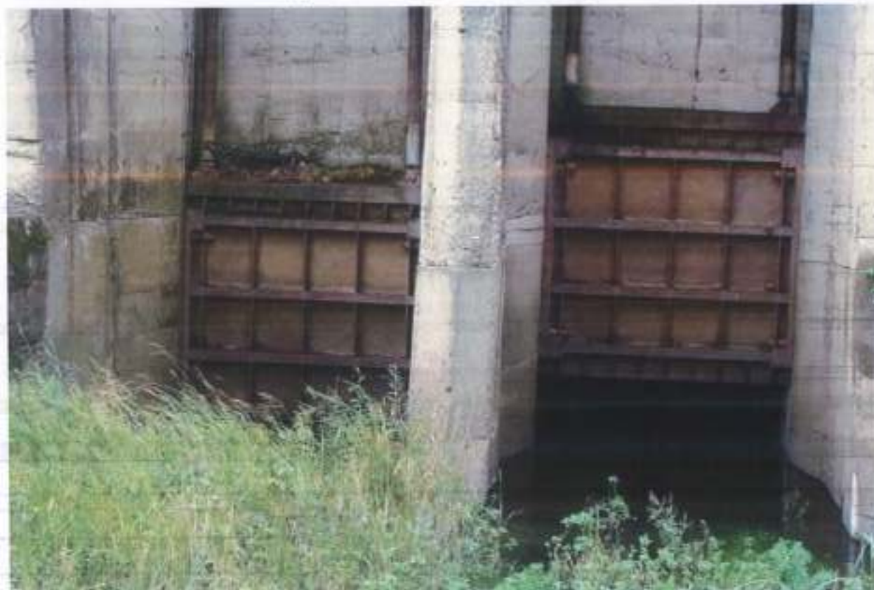
Figura 21 -Lipsa protecției atvoroazive a stăvililor plane și a tijelor de acționare
