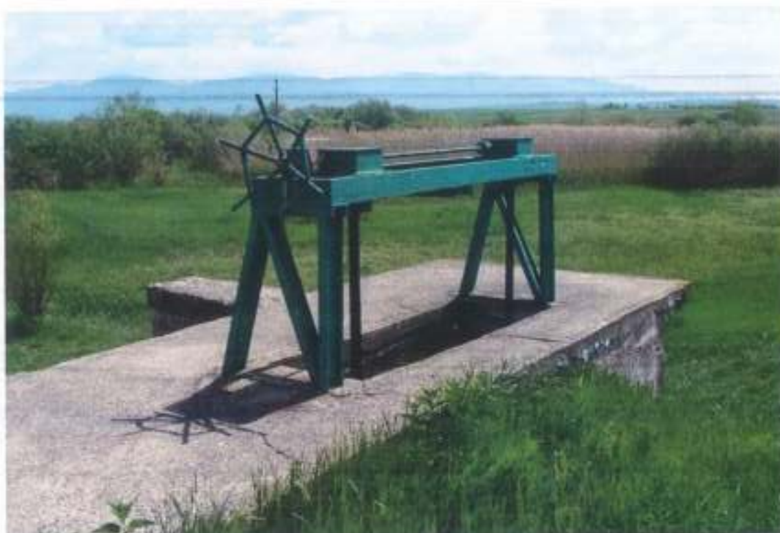
Figura 4 - Mecanismul de acționare aferent stâvilărilor principale de golire- uzat fizic și moral după 35 de ani de exploatare
