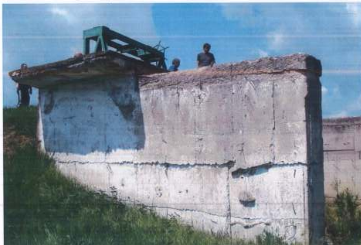
Figura 9 – Lipsa mirelor hidrometrice pentru determinarea volumelor atenuate în incinta polderului, respectiv a debitelor evacuate
