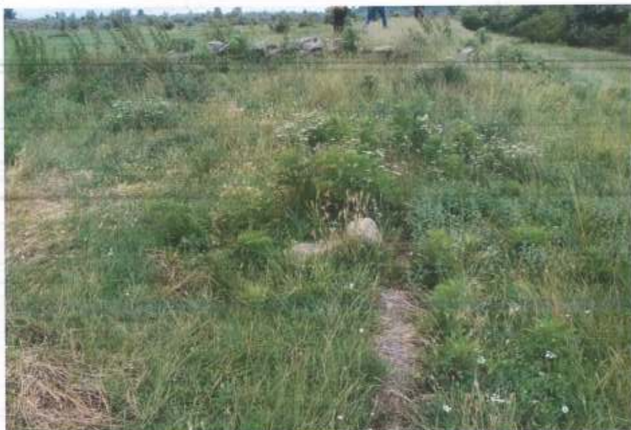
Figura 18 -Degradarea accentuată a protecției din zidărie de piatră a deversorului de admisie a apei dintrupe râul Ciornovăț
