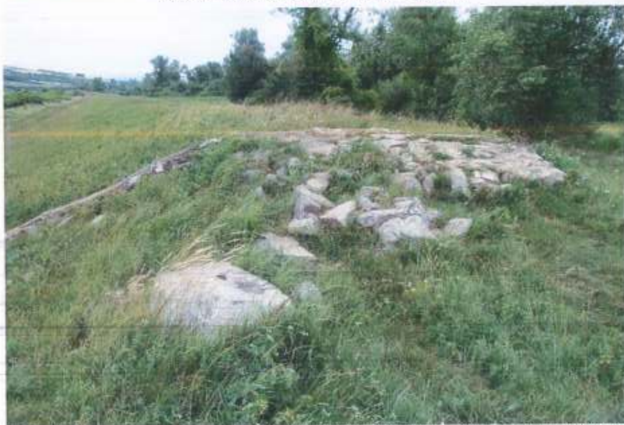
Figura 17 – Degradarea accentuată a protecției din zidărie de piatră a deversorului de admisie a apei dinspre râul Caraș
