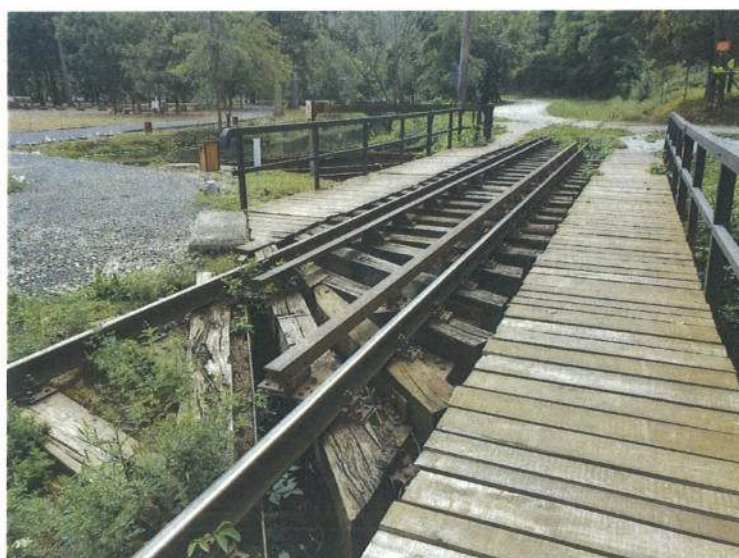
Figura 3.6.1-14 Starea actuală a podurilor de cale ferată pe Linia 124: Timișoara Nord – Voiteni
