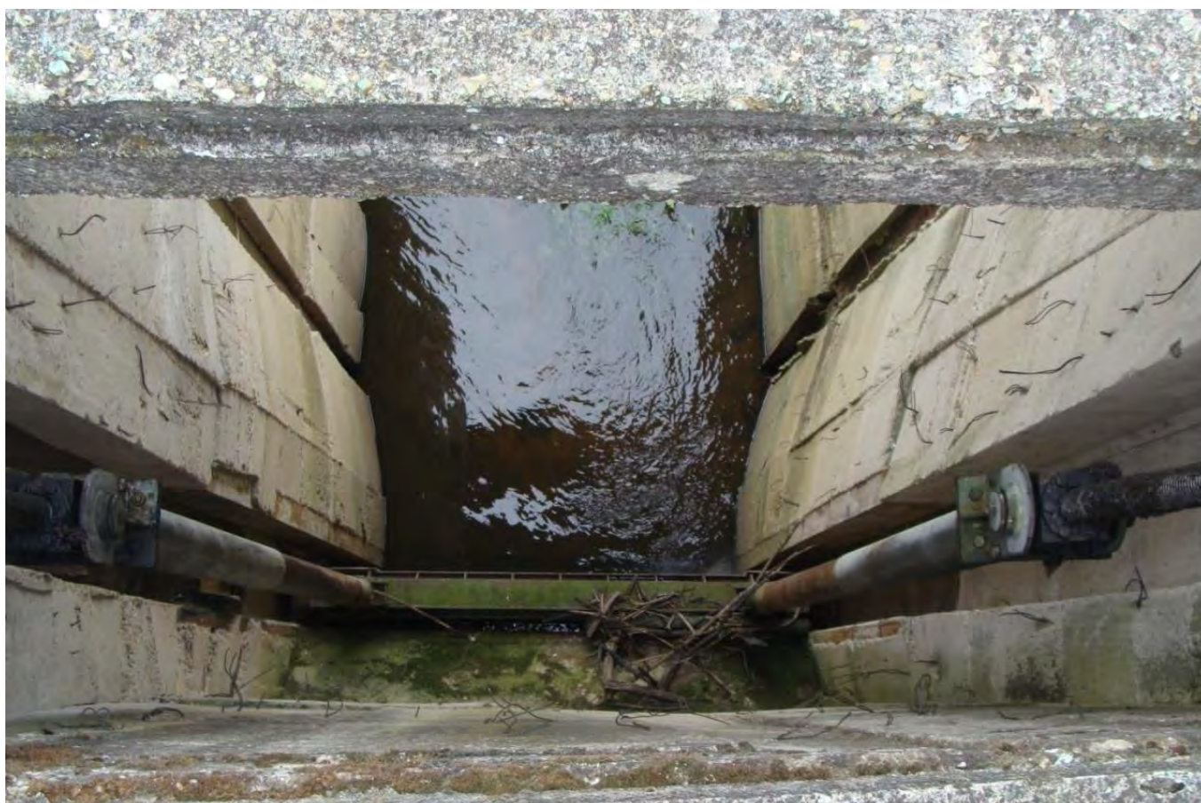
Figura 15 – Acționarea manuală a stăvililor plane în lipsa asigurării cu energie electrică
