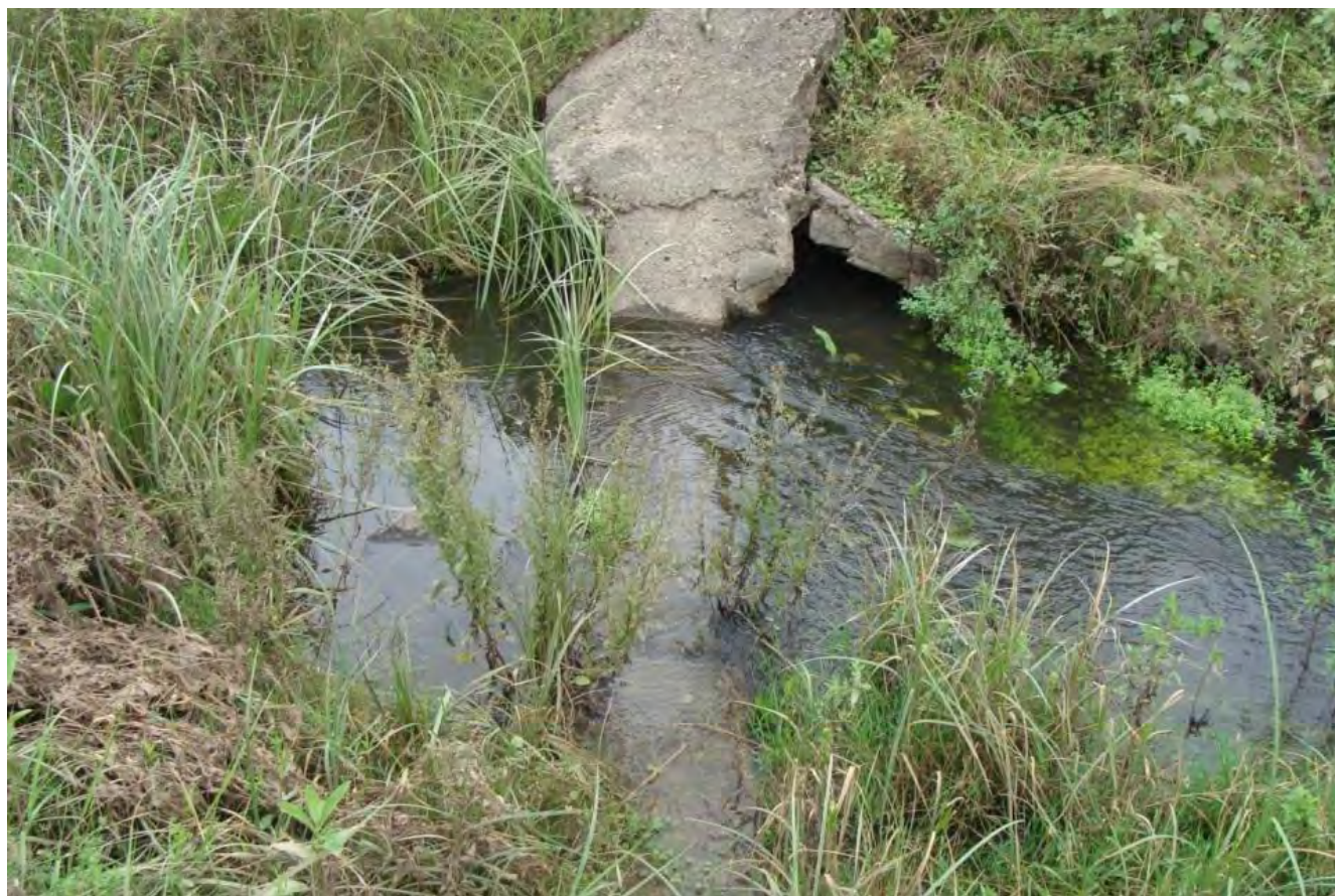
Figura 16 – Degradare pragului de fund în incinta polderului
