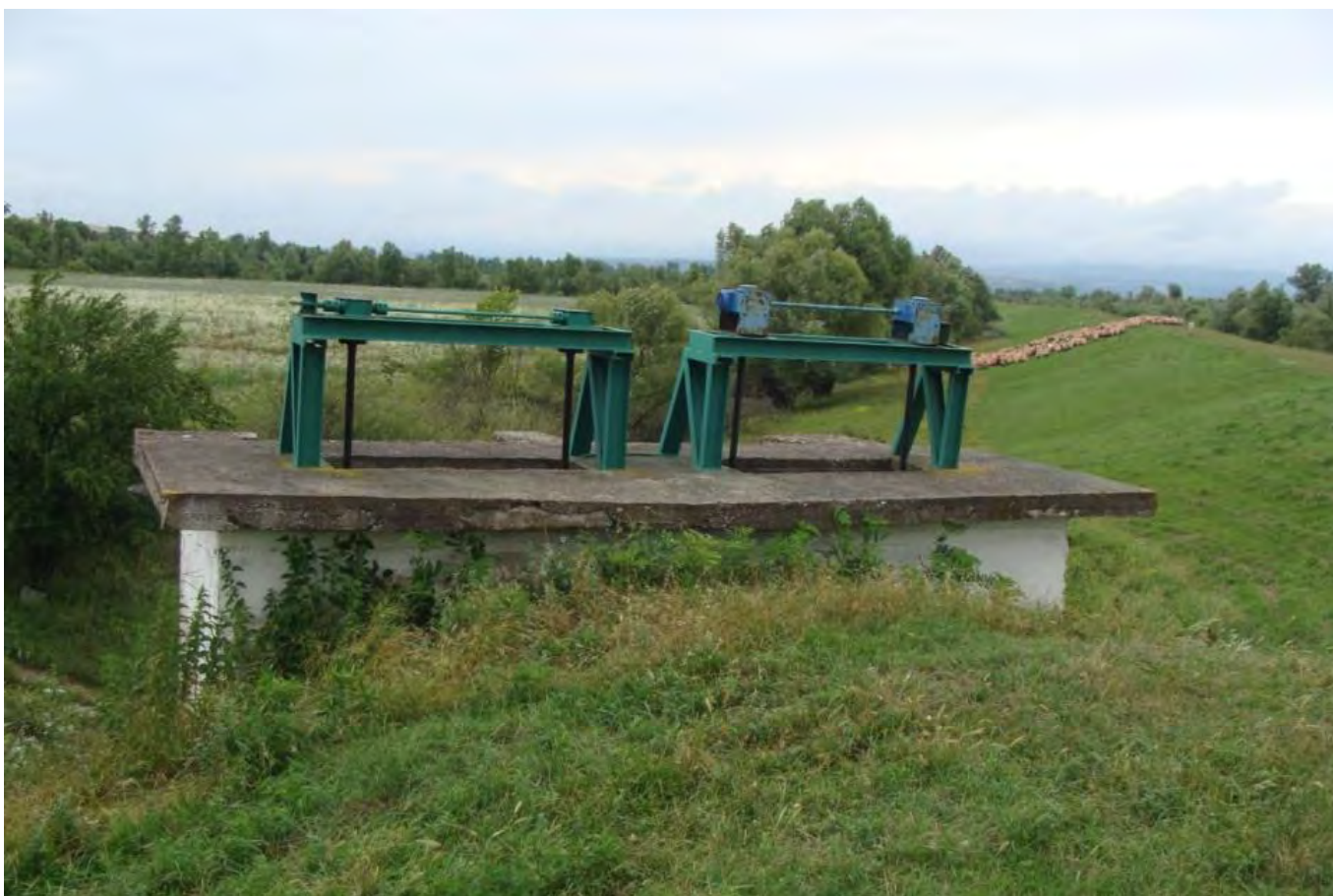
Figura 13 – Uzură fizică și morală a sistemelor de acționare aferente golirilor de fund
