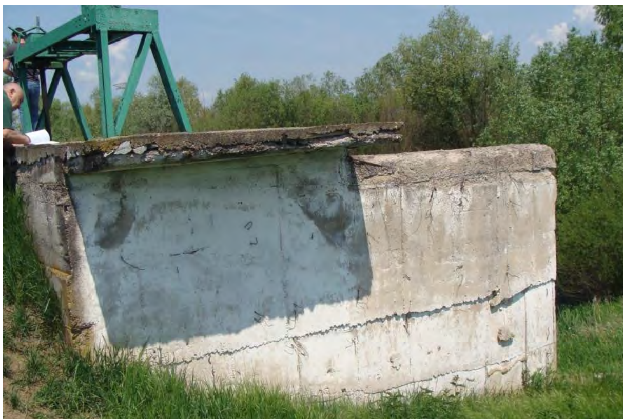
Figura 5 – Degradări structurale la nivelul platformei pentru manevrare EHEM
