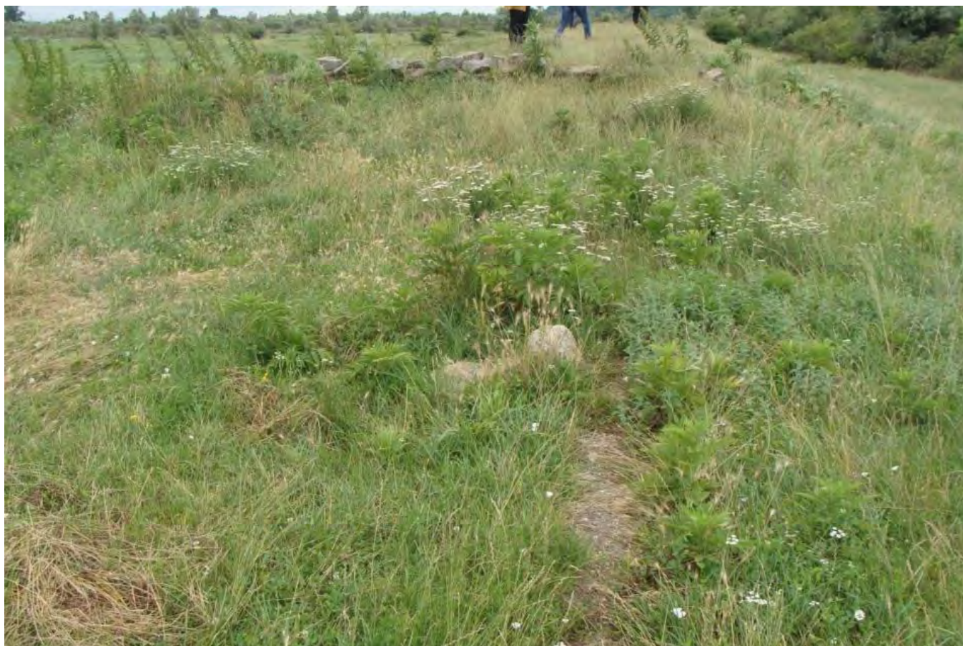
Figura 18 -Degradarea accentuată a protecției din zidărie de piatră a deversorului de admisie a apei dinstrpe râul Ciornovăț
