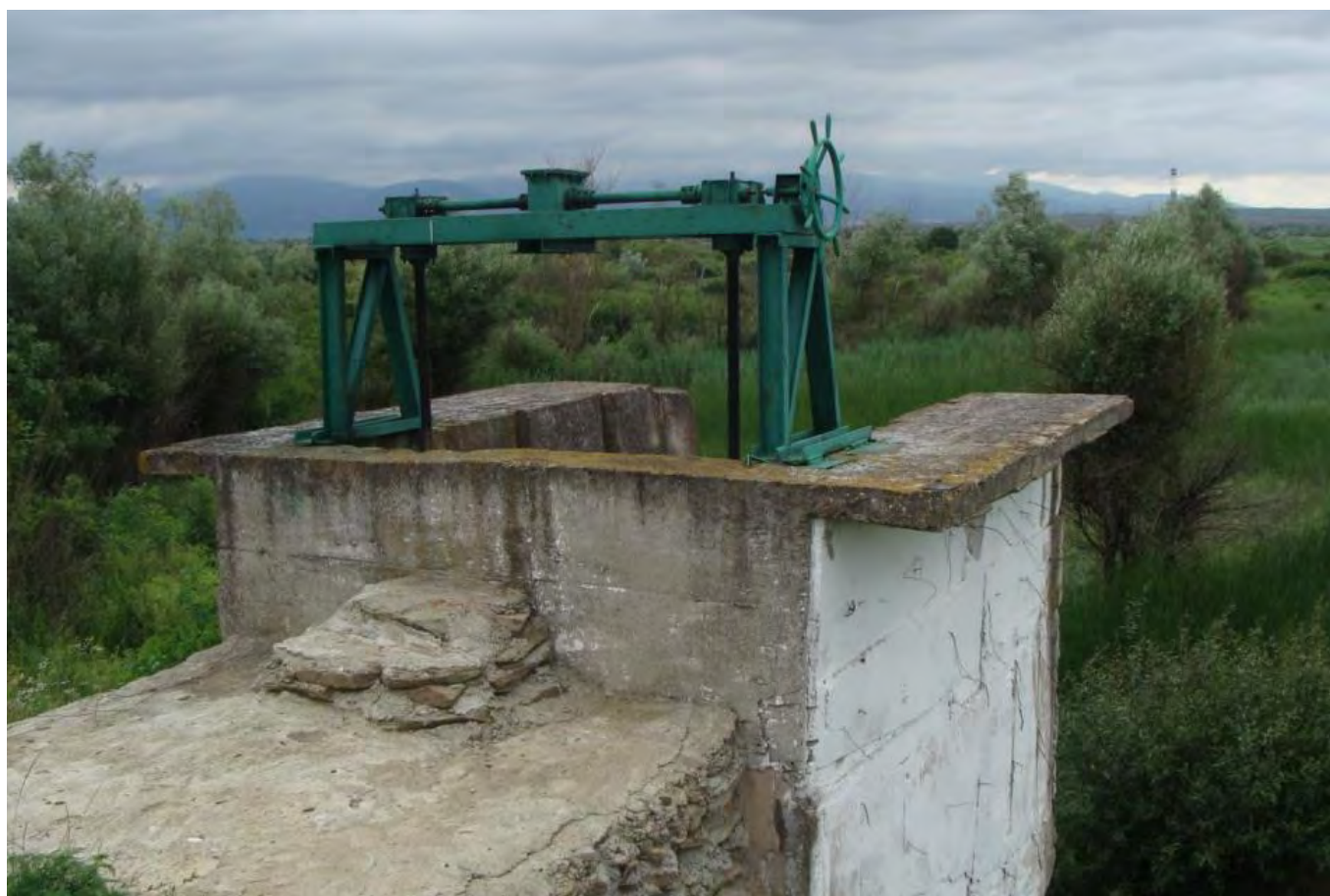
Figura 11 – Golirea de fund a compartimentului 1 spre râul Caraș
