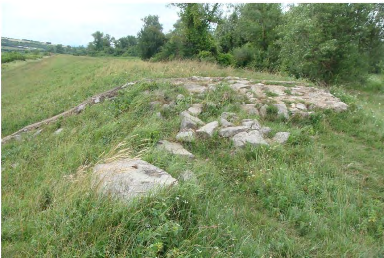
Figura 17 – Degradarea accentuată a protecției din zidărie de piatră a deversorului de admisie a apei dinspre râul Caraș
