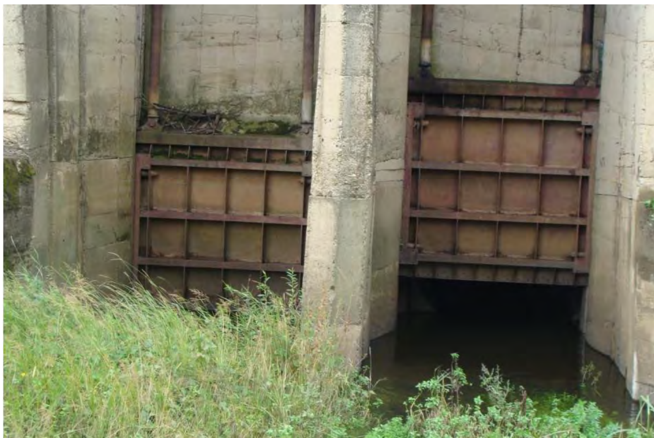
Figura 21 -Lipsa protecției ativorozive a stăvililor plane și a tijelor de acționare
