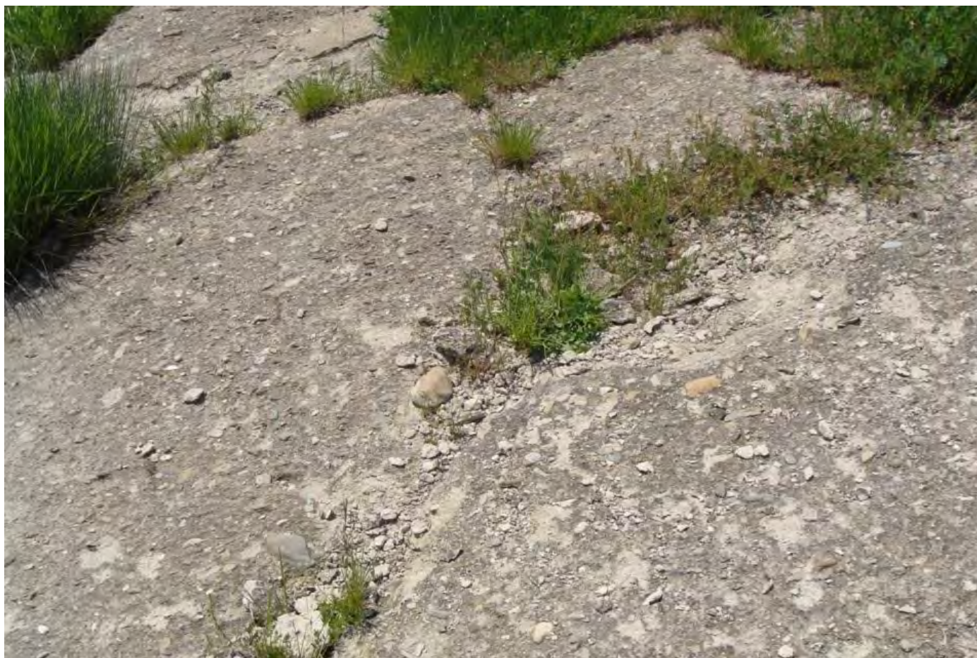
Figura 7 – Degradări pe zone extinse ale pereului din dale de beton, apariția vegetației în rosturile neraturate
