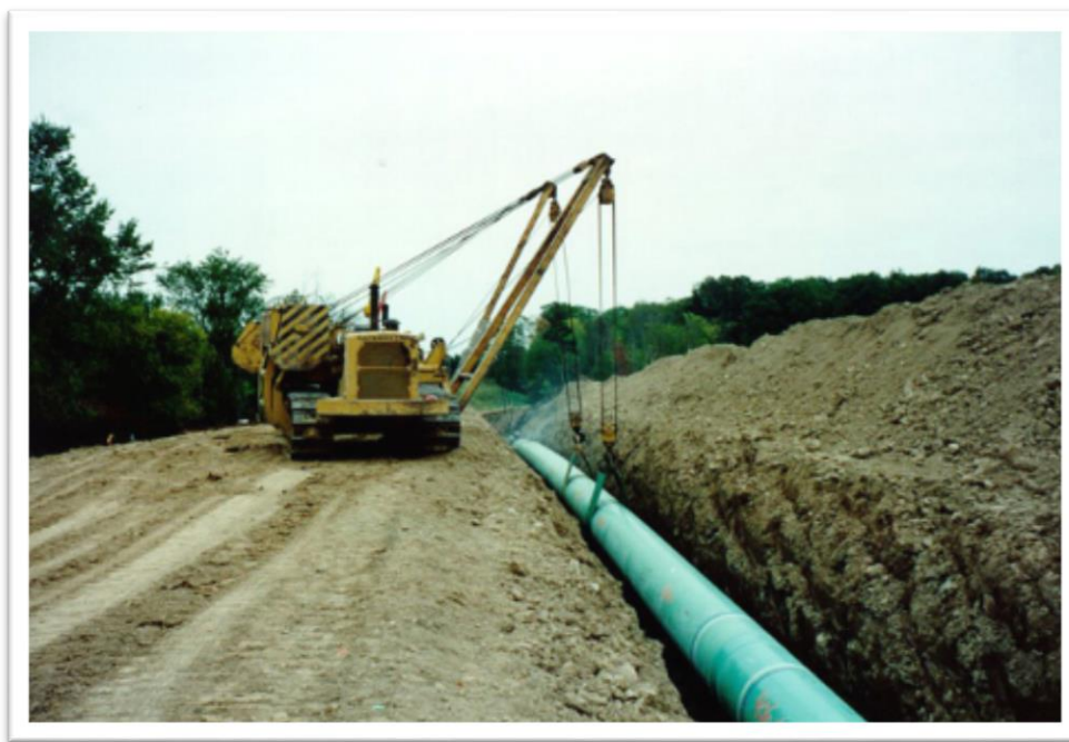
Figura 2.2.4.2.-1 Prezentare a modul de lansare a unei conductei de transport gaze naturale în șanț
