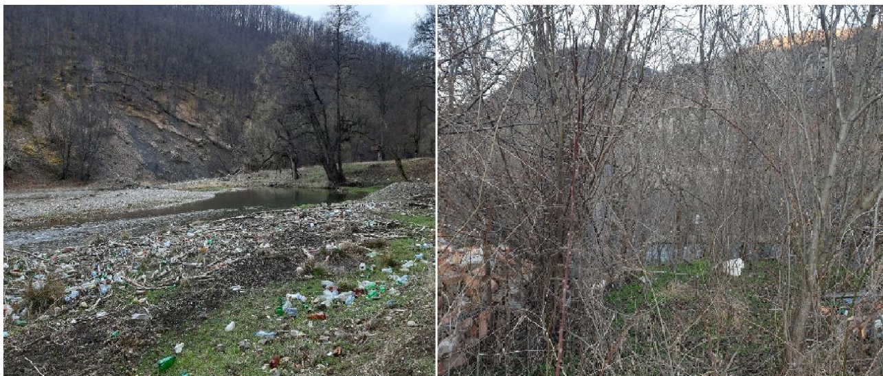
Figura nr.2.13-1 Aspecte amplasament privind depozitari ilegale de deseuri in ariile protejate
