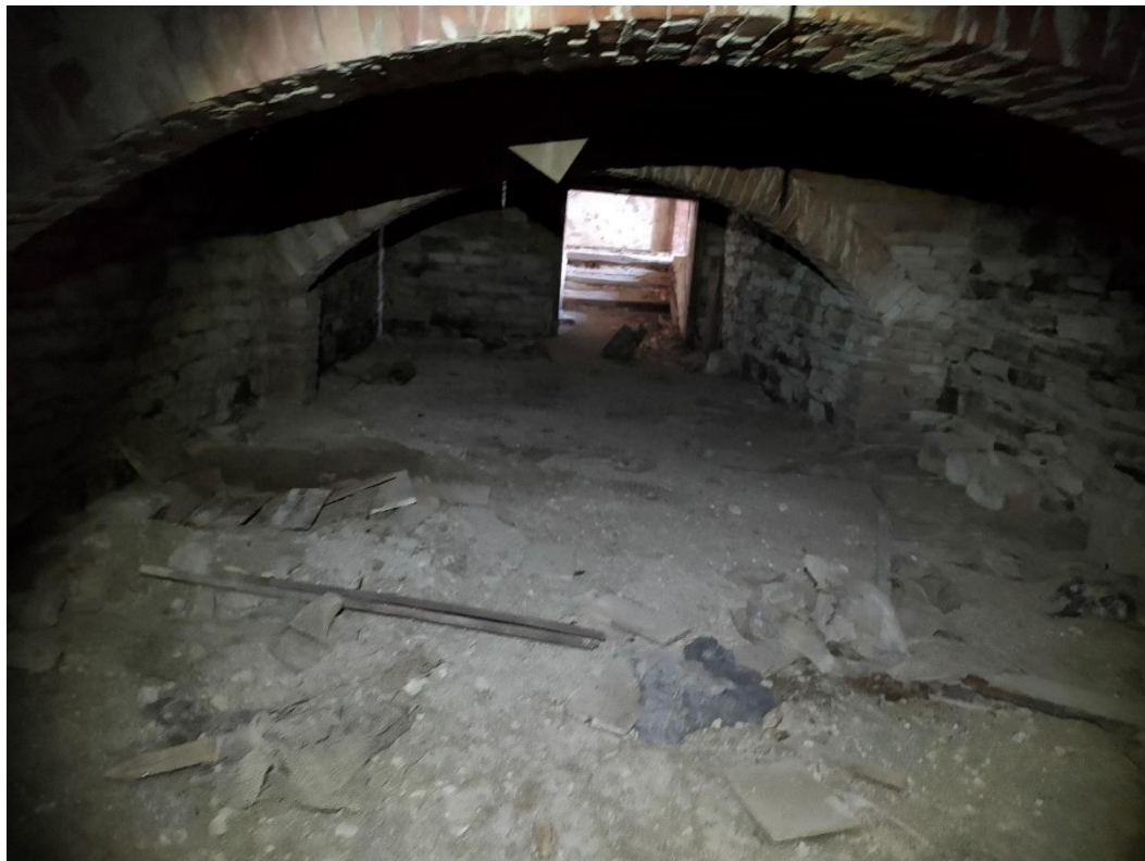
Fotografia 19: Beci clădire abandonată cu urme de guano
